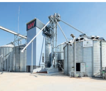
Installation de stockage Westeel, manutention fixe Skandia et séchoir colonne LAW
